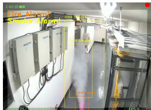
採用影像分析煙、火災害
